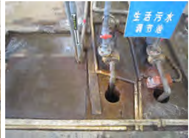
生活污水调节池
