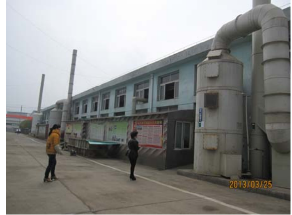
电镀废气处理设施
