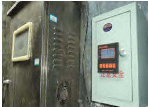
污水站排口处在线流量监测设施
