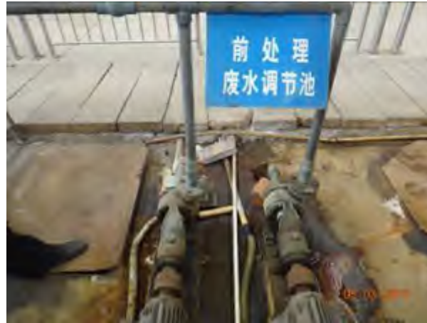
前处理废水调节池
