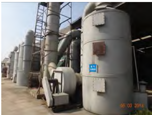
前处理、酸洗活化工序废气洗涤塔
