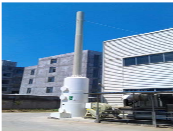
碱洗废气处理系统
