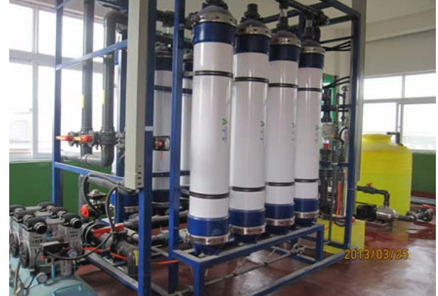
中水回用系统超滤装置
