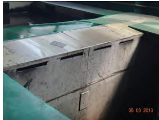
酸洗槽侧吸风口
