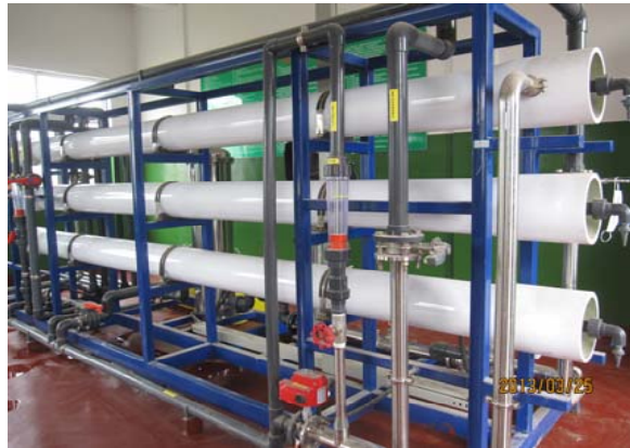
中水回用系统 RO 装置
