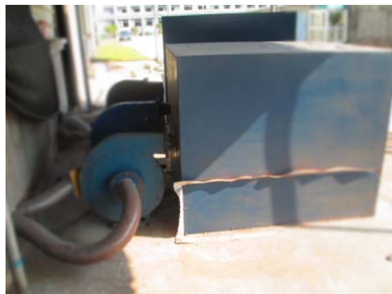
打磨废气处理设施
