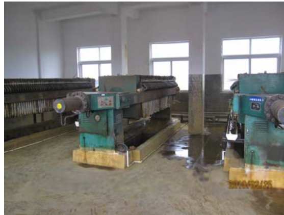
污水站污泥压滤间
