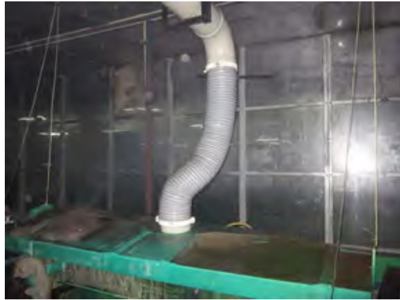
车间废气收集系统
