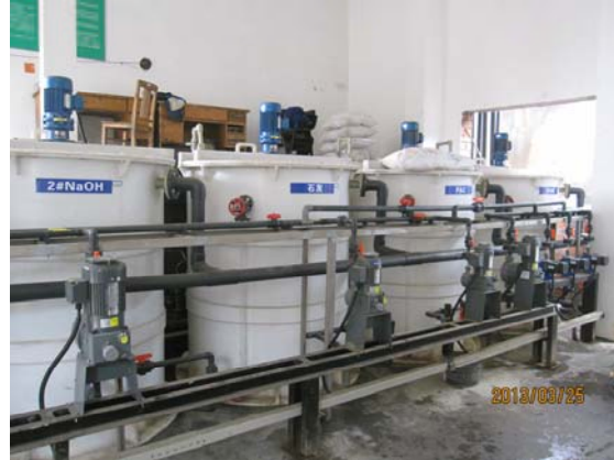
废水处理系统加药间
