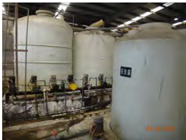
酸、碱及药洗储罐
