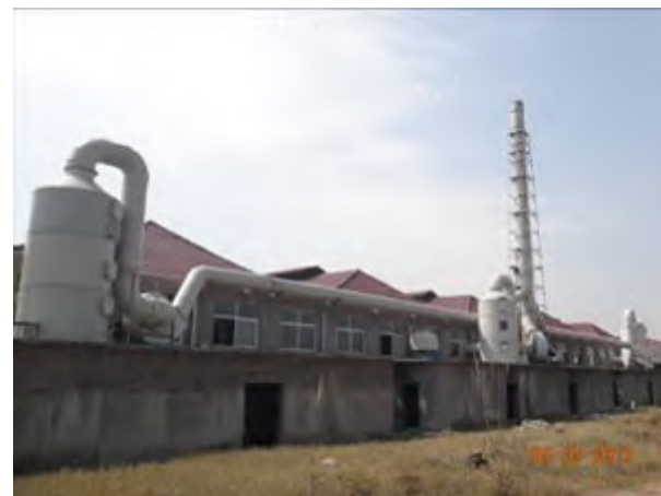
预镀铜工序废气洗涤塔
