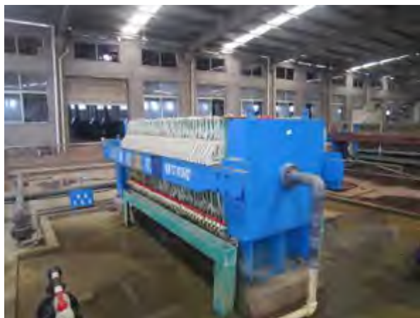
污泥压滤设备
