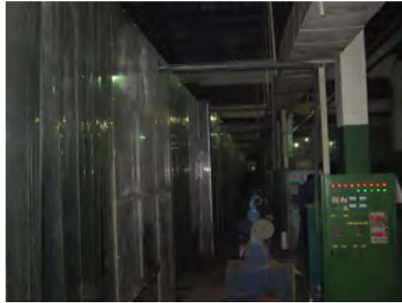
车间废气收集系统
