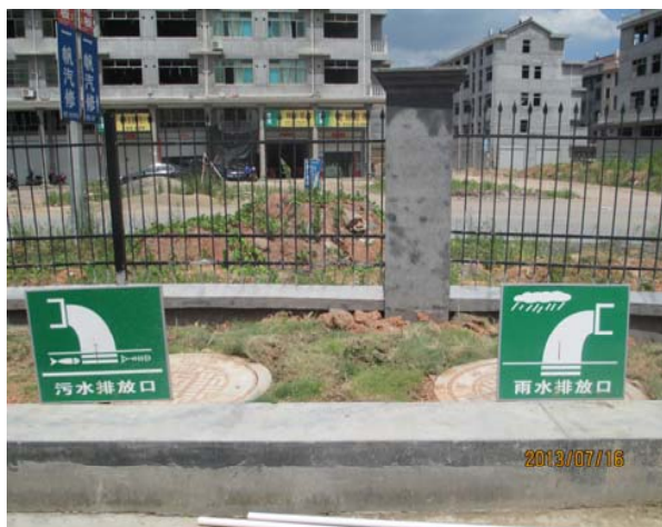
废水、雨水总排放口
